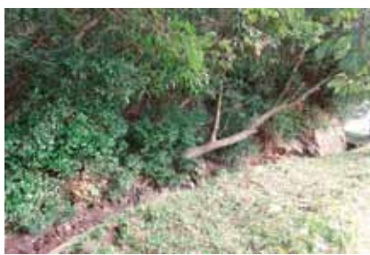
根が水路を壊しそうな木
