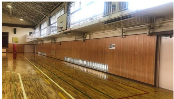
(屋内運動場 空調設置(例))
