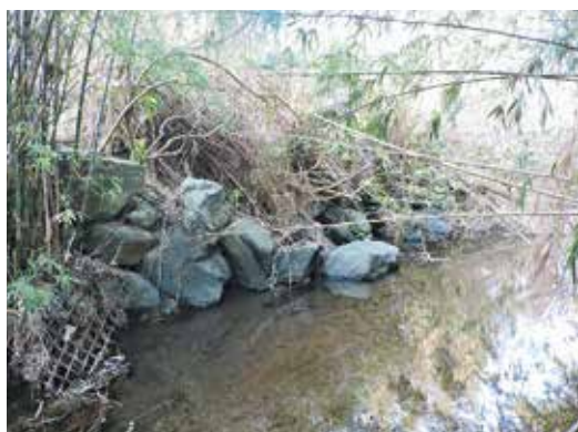
護岸決壊している古里川
