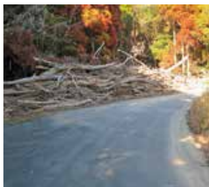
台風6号により被災した道路
