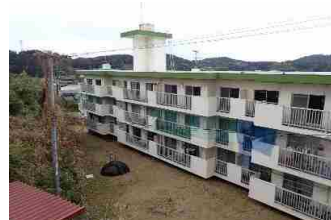
( 高架水槽 状況 )
